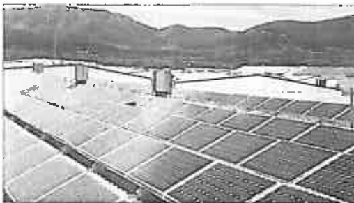
CATALUÑA. Planta fotovoltaica de Husesolar en Tarragona.
